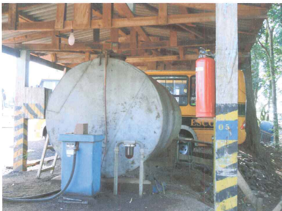
Fig. 2 – Pátio de Maquinas – Tanque de Abastecimento
